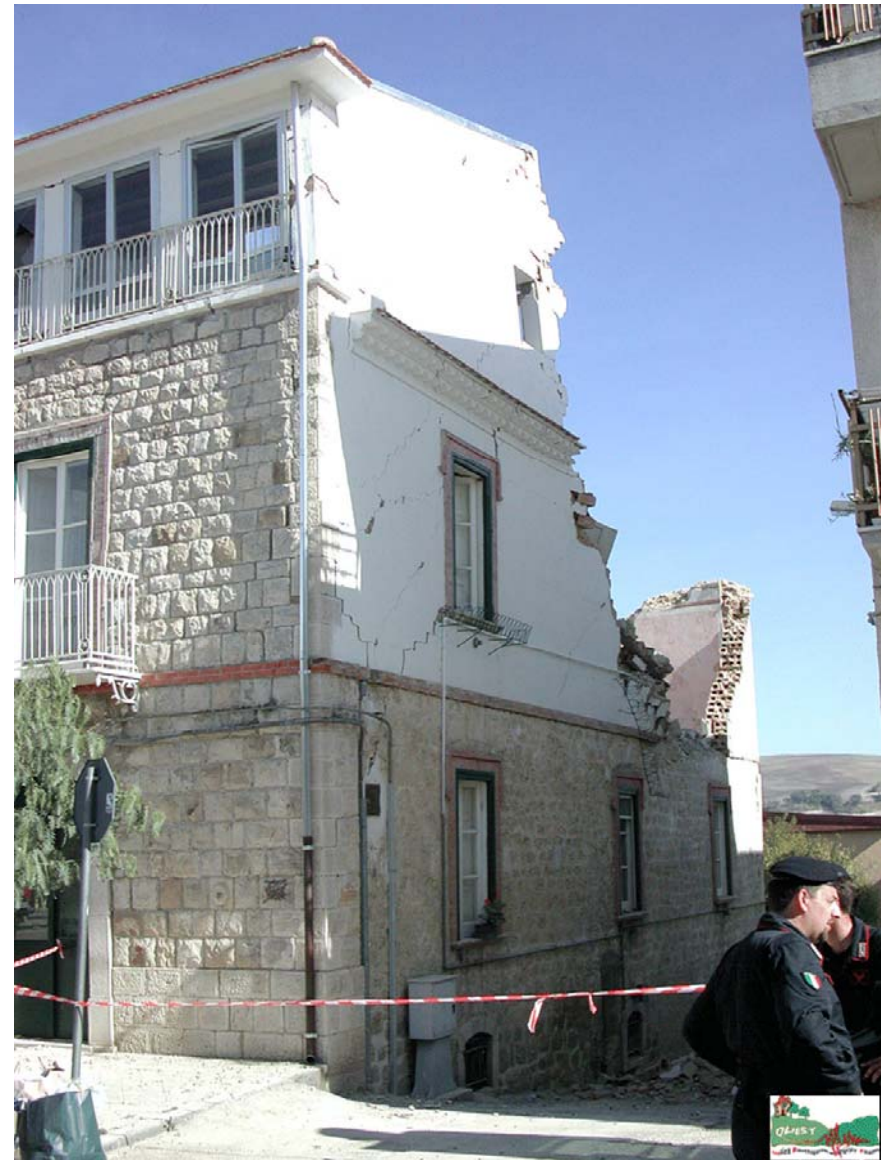
Séisme de San Giuliano Italie 2002
