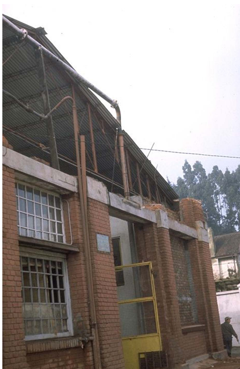
Absence de chaînages verticaux séisme du Chili, 1960
